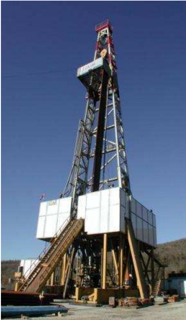
Figura 6-12: Impianto MAS 6000 E
